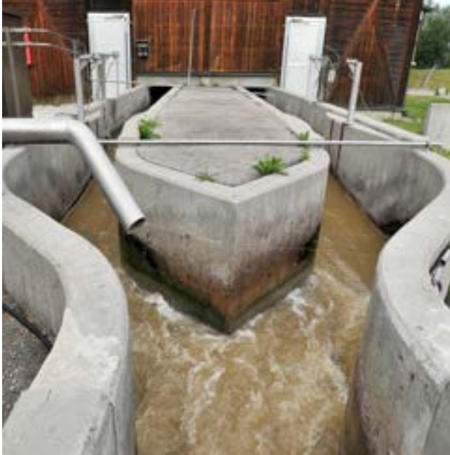
Zulauf der Kläranlage
